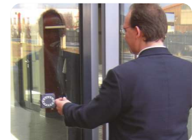
Zutrittskontrolle mit abgesetztem Leser am PZE-Master. Access control with external reader at PZE-Master.
