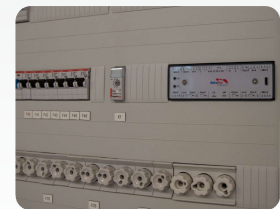
Einbau des KYO Fourlocs im Verteilerschrank. Installation of the KYO Fourlocs in the distribution cabinet.
